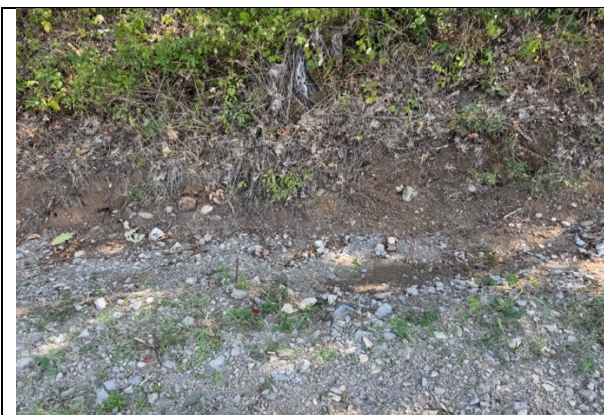
Състояние на откосите (северна лента). Посока на движение от гр. Монтана към гр. Видин
