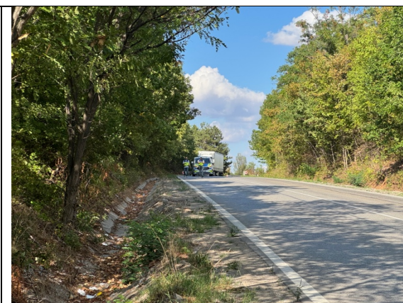
Състояние на откос при облицован земен окоп (северна лента при посока на движение от гр. Монтана към гр. Видин)
