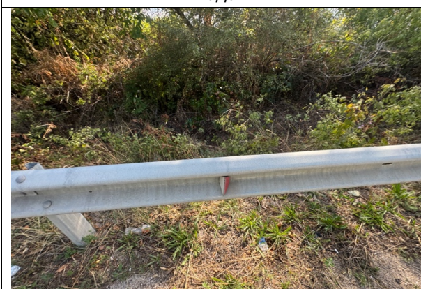
Състояние на откосите зад ОСП (северна лента). Посока на движение от гр. Монтана към гр. Видин
