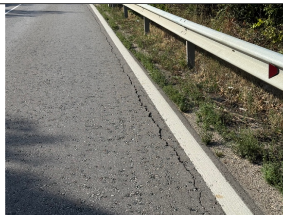
Пукнатина по ръба на настилка
