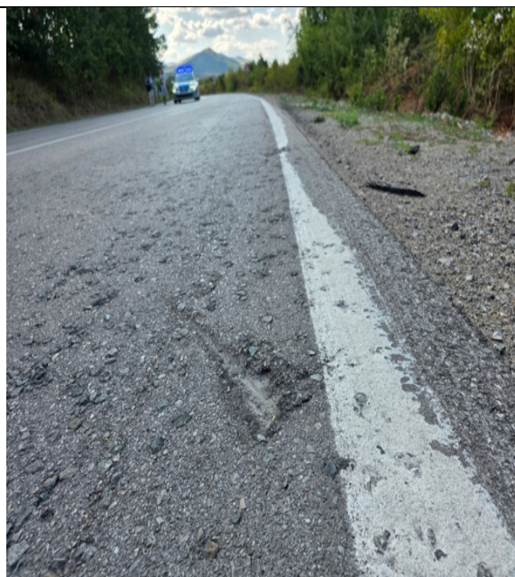
Състояние на банкета – южна лента с посока (гр. Видин←гр. Монтана)
