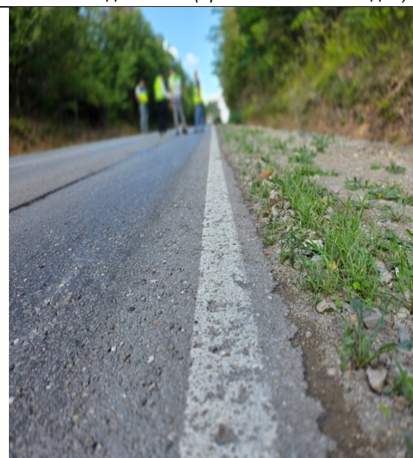
Състояние на ръба на пътната настилка – южна лента платно с посока на движение (гр. Видин←гр. Монтана)
