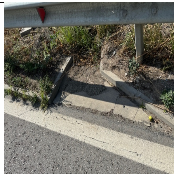
Силно затревен и запушен от кални и пясъчни наноси бетонов линеен отводител
