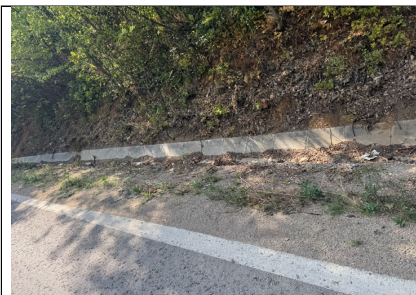
Състояние на откос с облицован окоп (южна лента при посока на движение от гр. Видин към гр. Монтана)
