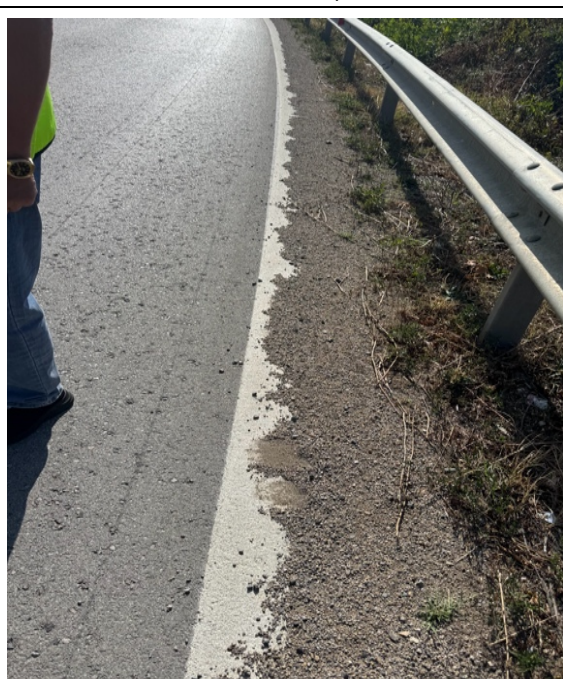
Състояние на банкета при ОСП – южна лента с посока на движение ( гр. Видин ← гр. Монтана)
