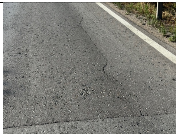
Състояние на асфалтовото покритие при ненапречна fuga
