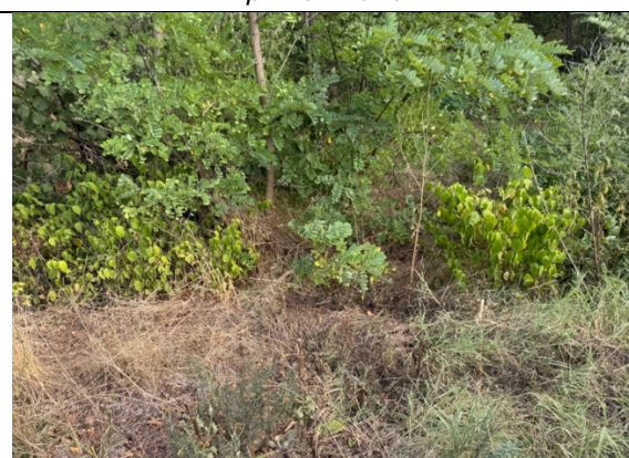
Състояние на откосите (южна лента). Посока на движение от гр. Видин към гр. Монтана
