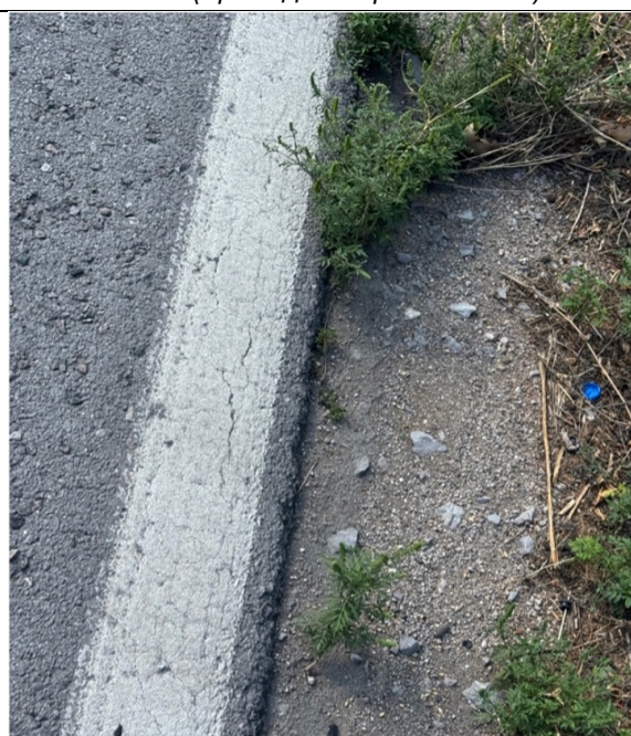
Състояние на ръба на настилка – северна лента с посока на движение (гр. Монтана→гр. Видин)
