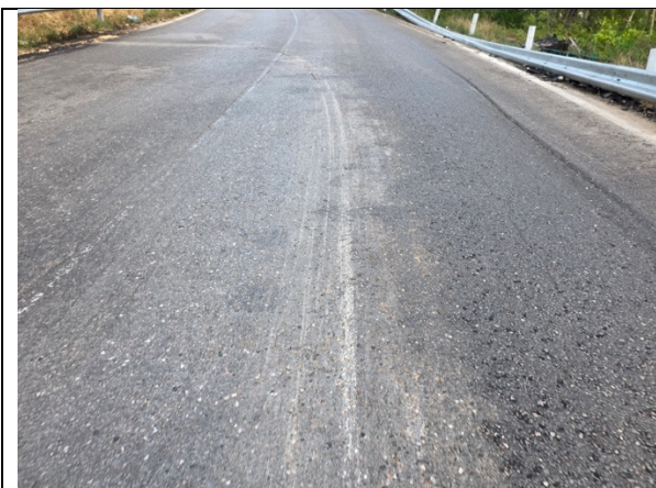
Състояние на асфалтовото покритие, общ поглед
