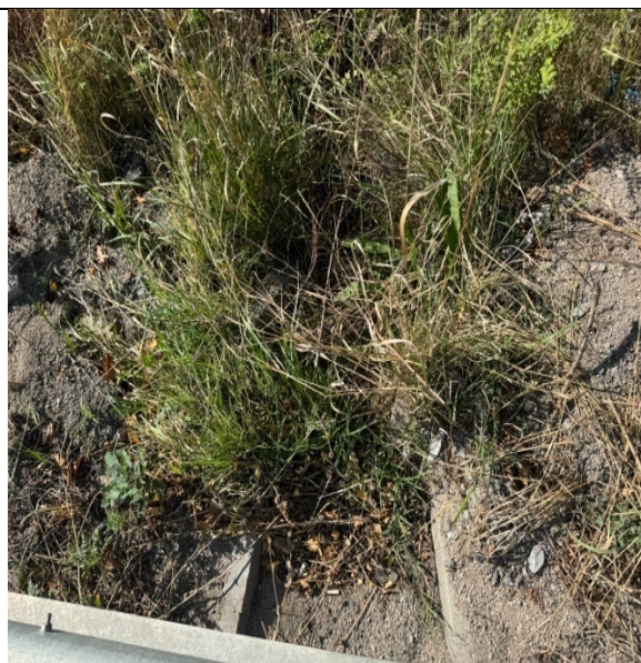
Силно затревен и запушен от кални и пясъчни наноси бетонов линеен отводител
