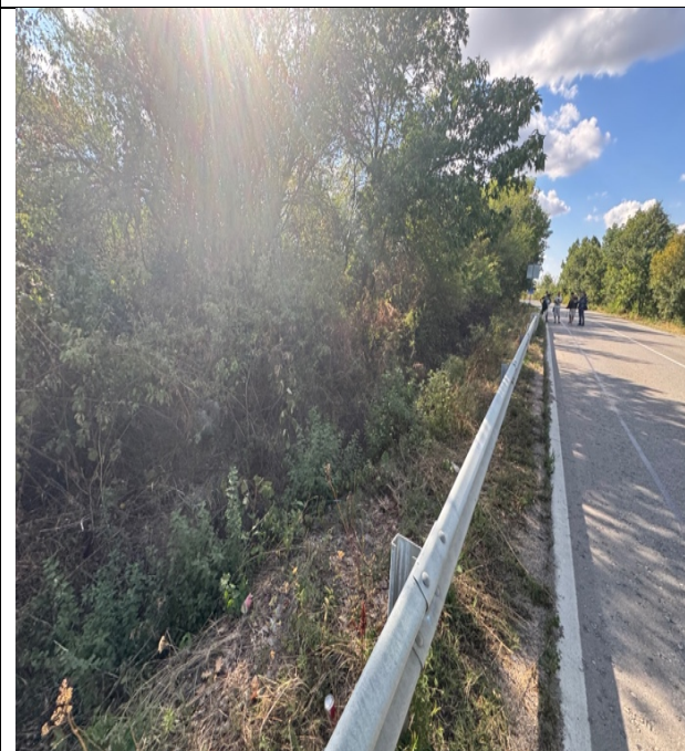
Състояние на банкета при ОСП– северна лента с посока на движение ( гр. Монтана → гр. Видин)
