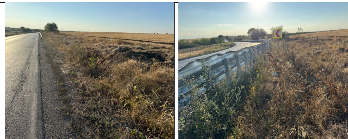
Състояние на откосите в изследвания участък (посока от гр. Кнежа към гр. Бяла Слатина)
