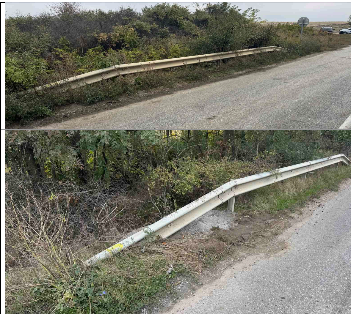
Състояние на ОСП от двете страни на водосток належащ се при км 65+770
