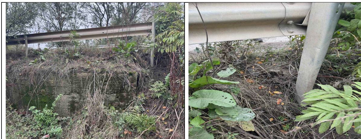
Състояние на ОСП над водостока (северната от южната страна)
