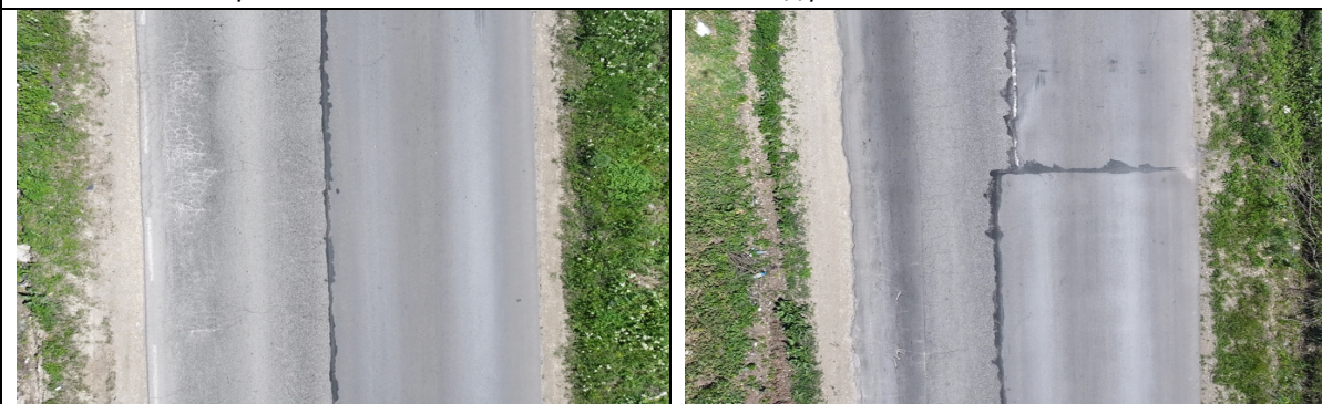
Състояние на ръба на настилка, кадри заснети по метода remote sensing. Заснемането е извършено от екип на ЕЦТП през април 2025 г.
