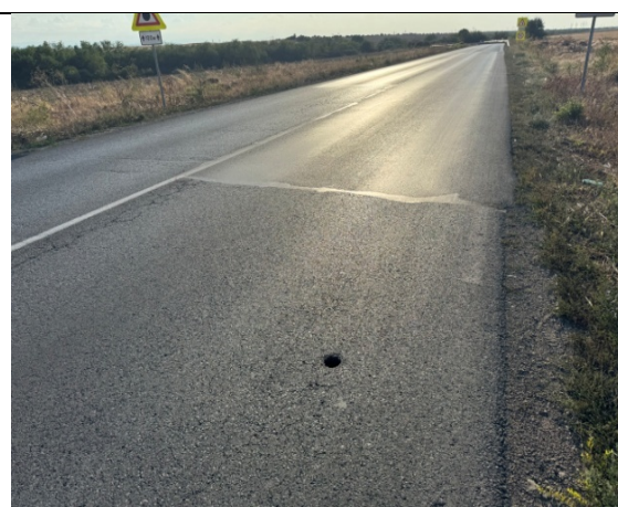
Състояние на крайната линия обозначаваща края на платното за движение (дясно платно посока от гр. Кнежа към гр. Бяла Слатина). Снимката е заснета през м. Септември 2025 г. след обезопасяването на УКПТП
