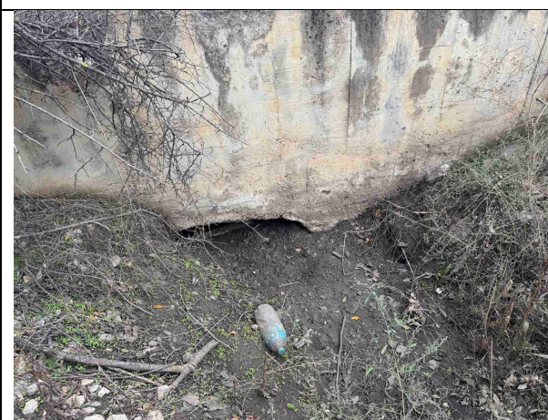
Състояние на водосток – изглед от южната страна на пътя (посока на движение от гр. Бяла Слатина към гр. Кнежа)
