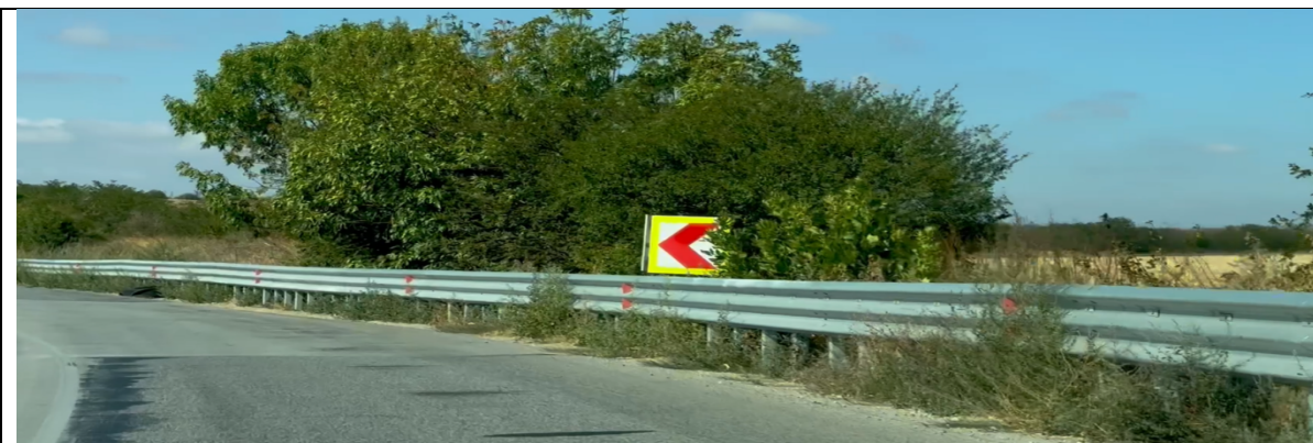
ОСП в кривата в посока от гр. Кнежа към гр. Бяла Слатина, където е ясно видимо, че растителността не е почиствана след ръба на настилка
