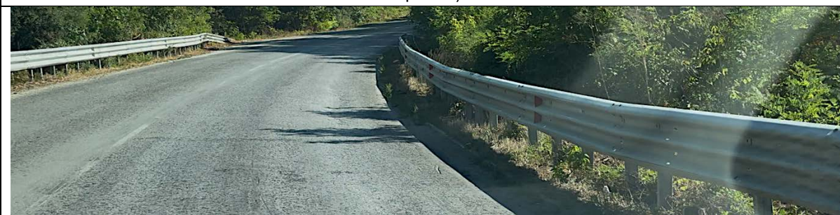
Ясно видими надлъжни пукнатини върху платното за движение в зоната на водостока (посока от гр. Враца към с. Борован)
