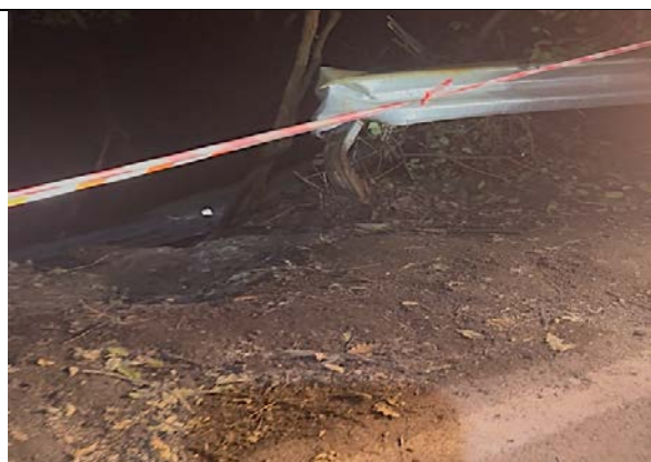
Състояние на откос и банкет в зоната на инцидента (снимка заснета от екипа на ЕЦНП, вечерта на 05.10.2025 г.
