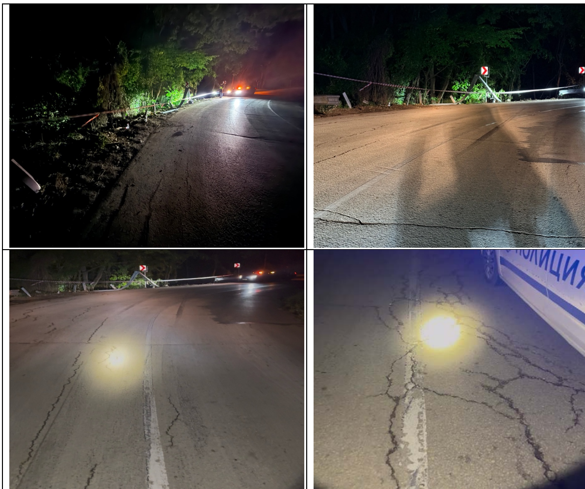
Състояние на асфалтовото покритие – изображенията са заснети вечерта след инцидента при огледа на ЕЦТП. От изображенията ясно се вижда критичното състояние на асфалтовото покритие.
